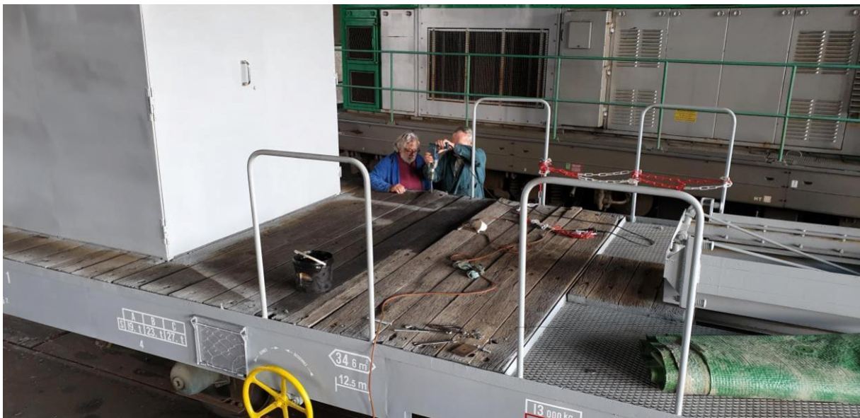
Wagon porte-rampes du CR8: Remise en état du platelage et traitement des bois
